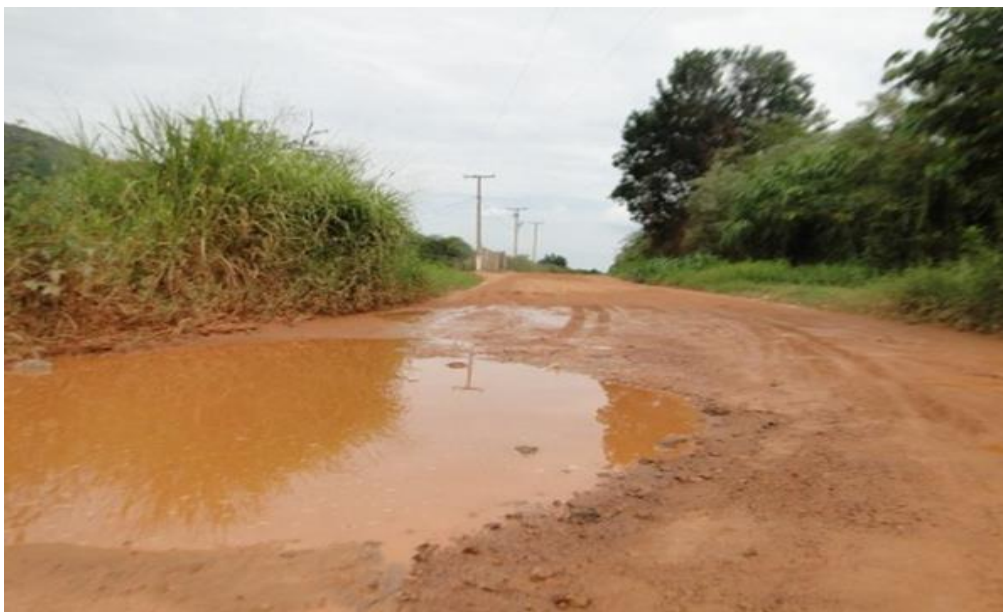
Figura 02. Presença de buracos/panelas em estradas canavieiras não pavimentadas
